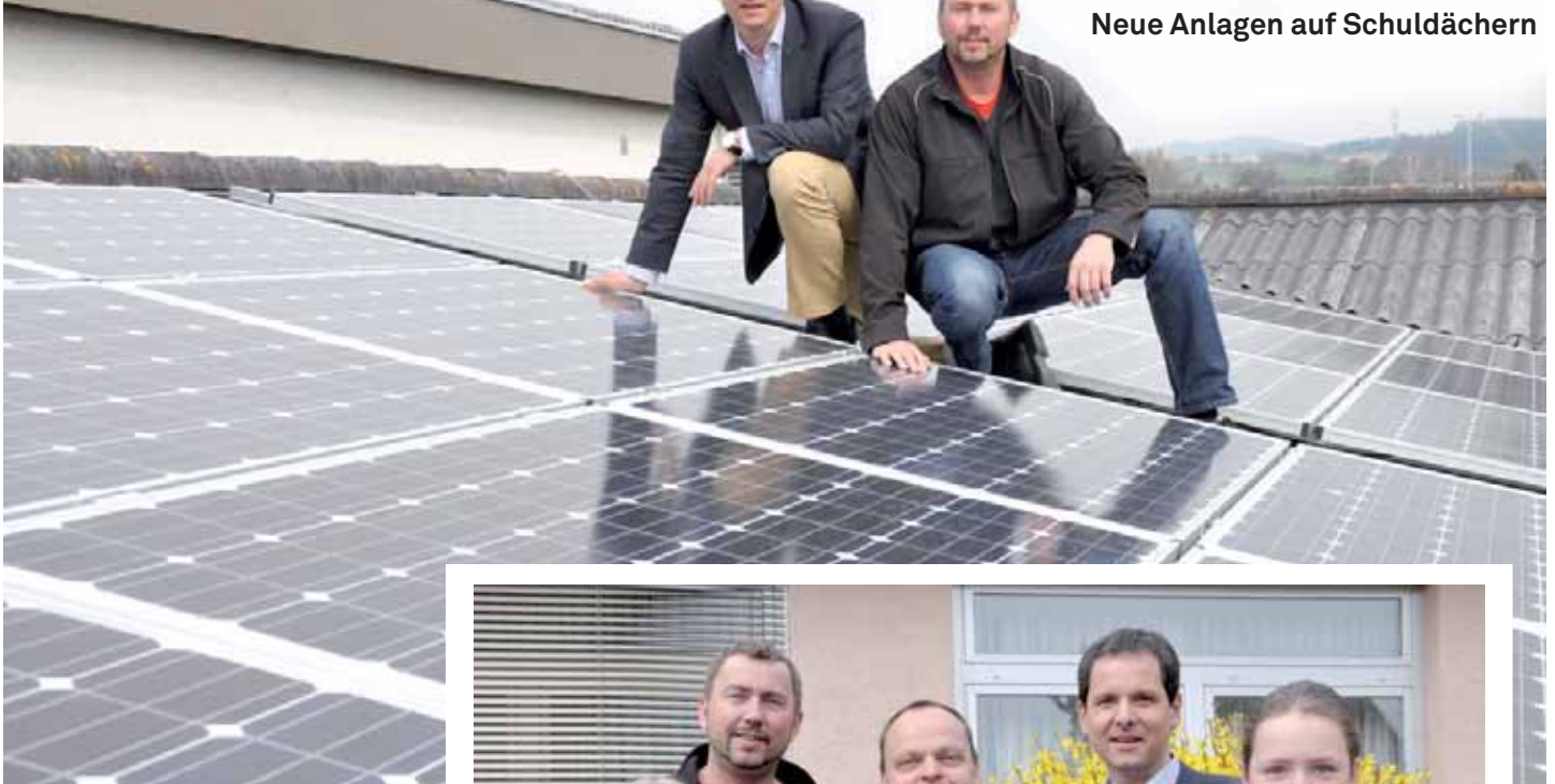
Bild oben: Jachs und Firmenchef Kern machen sich ein Bild der neuen Photovoltaik-Anlagen direkt vor Ort — und damit auf dem Dach.
